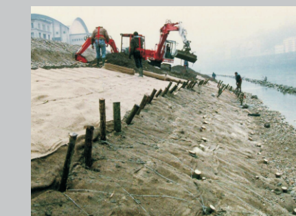
Realizzazione di copertura diffusa di salici: battitura dei pali per fissare l'opera al suolo
