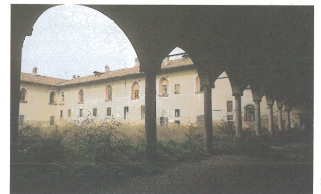
Il porticato all'interno del cortile del castello di Cusago, purtroppo in grave stato di abbandono (Itinerario B - n.2)
